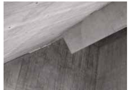
Abb. 37: Beispiel für gleichmässige Schalhautfugen an Decke und Wänden, Feinmörtelaustritt im Übergang (Arbeitsfuge) Decke/Wand
