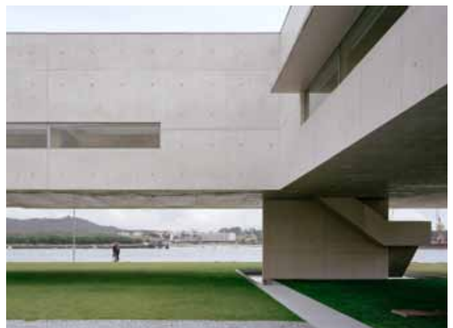
Abb. 49: Bewitterte Sichtbetonaussenwand einer Stadtbibliothek (SBK 2)
