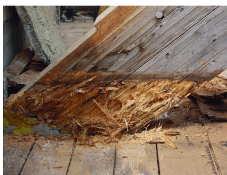
Links: Wachstum eines holzerstörenden Pilzes aufgrund einer fehlerhaften Deckendämmung.
